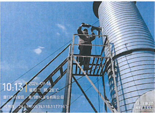
DA001 有机废气排放口
